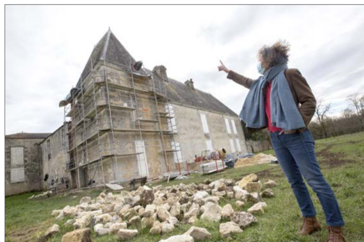
Le chantier de réfection des façades nord et ouest a déjà commencé.
